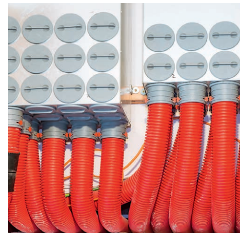
Von oben nach unten: Blick in ein Lüftungsgerät Verteilboxen für Zu- und Abluft und die Verteilungen im Bodenaufbau bzw. der Decke
