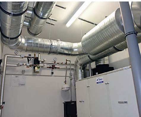
Lüftungszentrale für 15 sanierte Wohnungen
