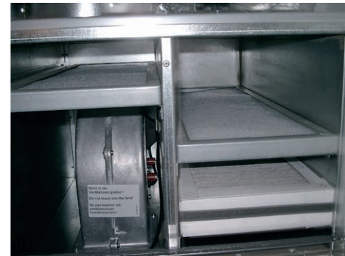
Filter in einem Lüftungsgerät
