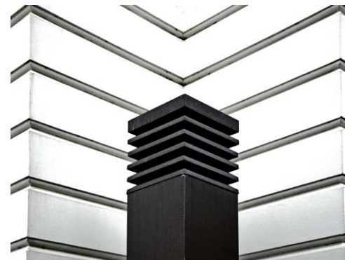
Außenluftelement als Gestaltungselement
