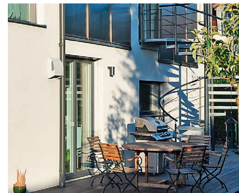
Außenluftelemente in der Fassade
