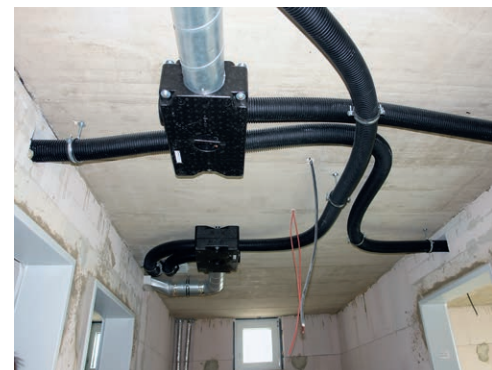
Sternförmige Erschließung über schallgedämmte Verteilboxen
