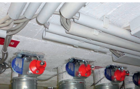
Von oben nach unten: Lüftungsleitungen mit Feuerschutzmantel Brandschutzklappen an der Decke der Lüftungszentrale im Keller
